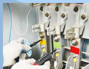
ELÉTRICA E AUTOMAÇÃO
